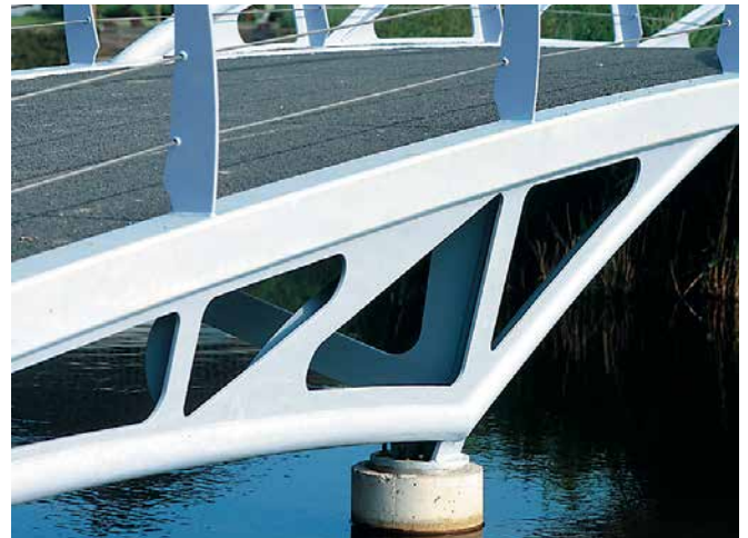
Het tussensteunpunt is enkele meters uit het midden verschoven.
