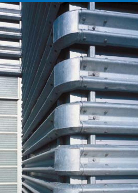
Verzinkt stalen vangrail in de gevel Alphen aan den Rijn 2002, GroupA
