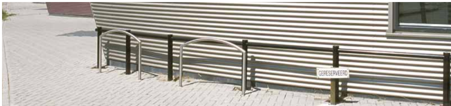
8.9 Afrasteringen en stoepanden beschermen de gevel tegen aanrijdschade.
