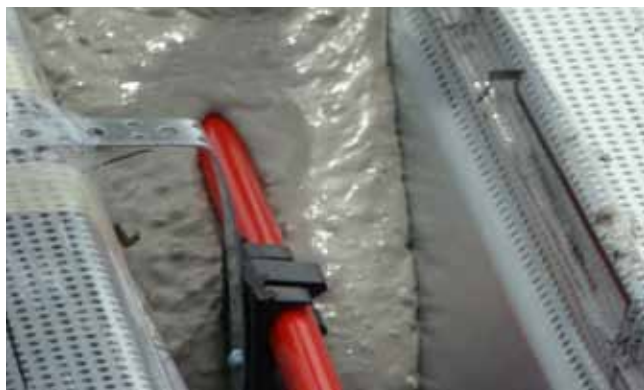
1.3 In het bedrijfsgebouw van Wilo in Zaandam zijn paraffine-bolletjes verwerkt in de betonlaag op de geprofileerde dakplaat. Deze paraffine-toeslag (phase changing material) buffert temperatuurswisselingen over een etmaal (foto: Corus).
