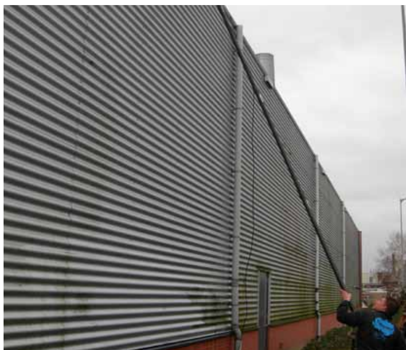
8.6 Het reinigingsmiddel wordt in principe van onder naar boven op een gevel aangebracht. De gevel wordt vervolgens van boven naar beneden afgespoeld.
