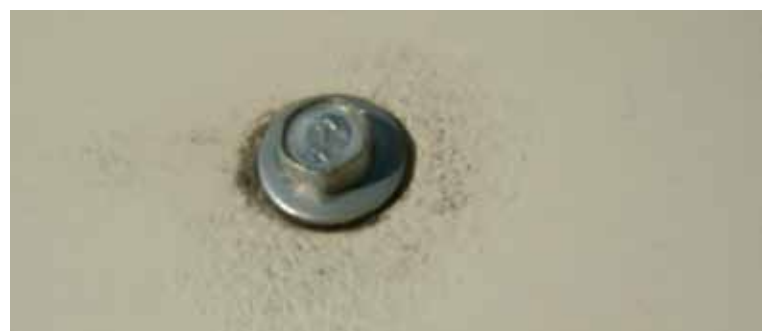
8.11 Blaasvorming rondom een bevestigingsmiddel. Gevels en daken moeten tijdens regulier onderhoud worden gecontroleerd op aantastingen en schaden. Gevoelige plekken verdienen extra aandacht. Het verhelpen of repareren van zwakke plekken is in een vroeg stadium geen kostbare zaak. Ook de eventuele eerste aanzetten van corrosie zijn dan tegen lage kosten te verhelpen.
