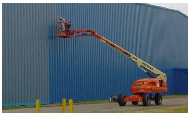
8.10 Bij kleine schaden bestaat de keuze uit een reparatie door kwast- of spuitapplicatie. Grotere schaden worden overgespoten.
