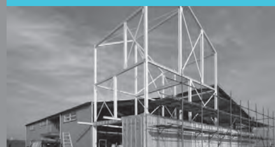
In de hoek van de bestaande hal is een staalconstructie geplaatst voor het kantoor.
